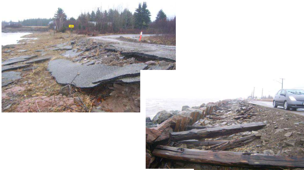
Figure 3. Exemple de dommages à la route provinciale # 535 à Cocagne en décembre 2010
